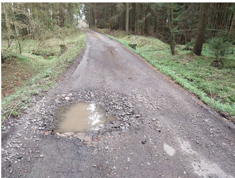
Obr. č. 3 z 20.4. 2023 - poruchy ve vozovce
