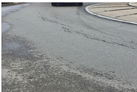
60/ Trhliny a ztráta pojiva na okružní křižovatce s II/360 (Litomyšl)
