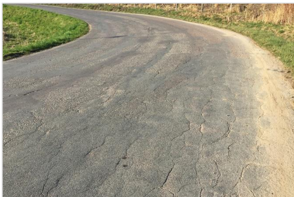
105/ Síťové trhliny, široká podélná trhлина a ztráta asfaltového tmelu (III/35719: Vysoké Mýto – Džbánov)
