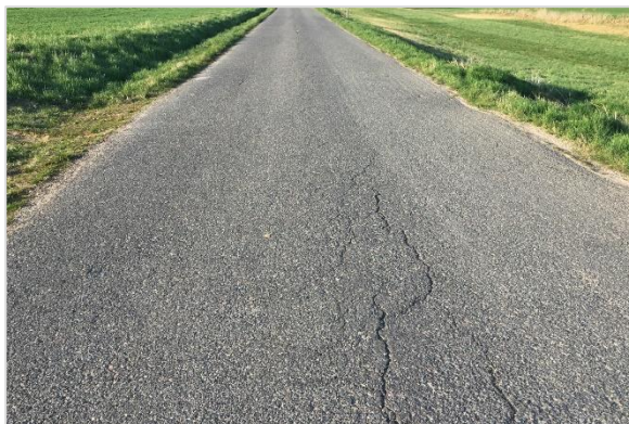
106/ Rozvětvená podélná trhлина, koroze vozovky a místní pokles (III/35719)
