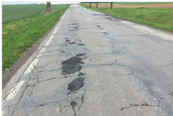
94/ Mozaikové trhliny, výtluky a plošné deformace okrajů vozovky (II/360: Horní Sloupnice – Němčice)
