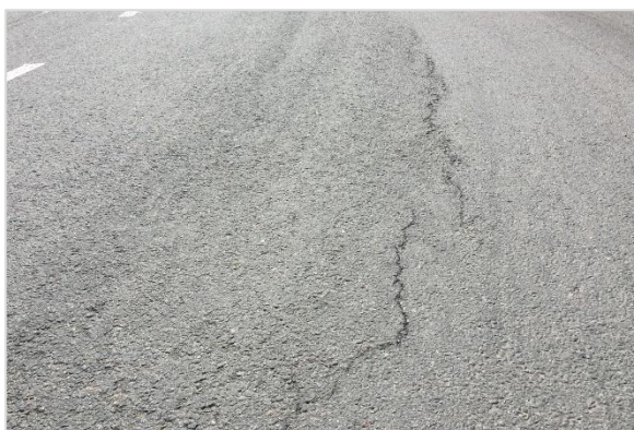
85/ Podélná trhlina v jízdním pruhu (II/315: Kerhartice – Hrádek)
