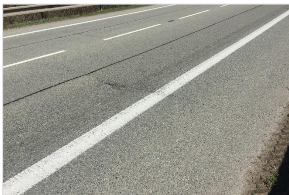
62/ Příčná trhlina se vznikajícím výtlučkem na pravém kole (I/35: Moravská Třebová – Borušov)
