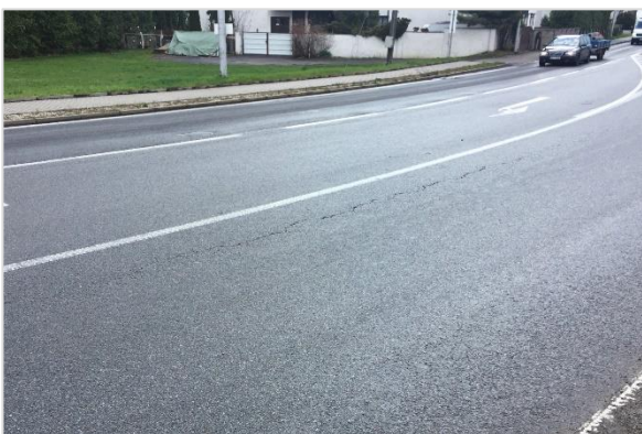
58/ Ojedinělá podélná trhlina v délce asi 15 metrů (I/35: Ostřetín 40)
