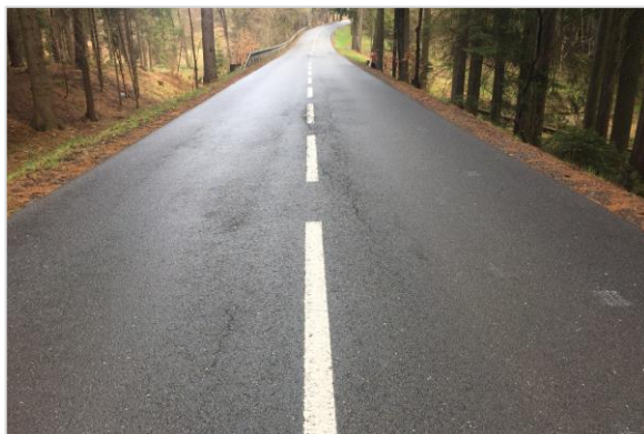
96/ Vznikající trhlina na středu, zřejmě vlivem nedostatečné únosnosti podloží (II/360: Řetůvka – Horní Sloupnice)
