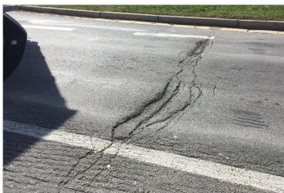
61/ Příčná trhlina, vyjeté koleje a vznikající výtlupek v řadících pružích SSZ (Litomyšl)
