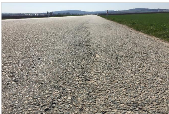
97/ Podélná rozvětvená trhlina, místní a podélný pokles (II/366: Jevíčko – Chornice)
