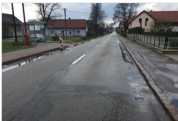
83/ Ve vyjetých kolejkách se na osychající vozovce drží voda (II/315: Dobříkov)
