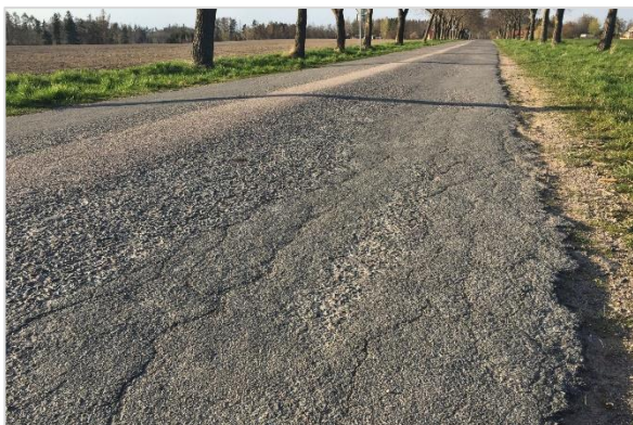
107/ Síťové a podélné rozvětvené trhliny a hloubková koroze (III/35722: Javorníček – Podhořany u Nových Hradů)
