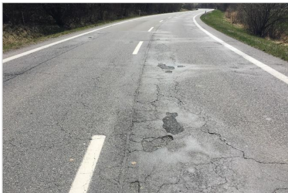
99/ Mozaikové trhliny, výtluky v ohrusné vrstvě a vysprávký (II/371: I/35 – Kerhartice)
