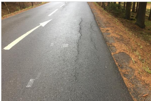
95/ Trhlina vznikající na novém povrchu z důvodu pracujícího podloží (II/360: Řetůvka – Horní Sloupnice)
