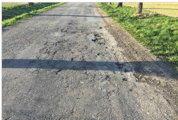
108/ Odlamování okrajů, výtluky a prolomení vozovky (III/35722: Javorníček – Podhořany u Nových Hradů)
