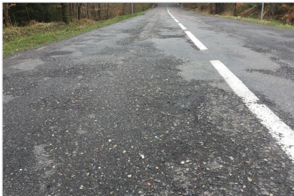
91/ Ztráta asfaltového tmelu a počátek koroze vozovky (II/360: Ústí nad Orlicí – Řetůvka)
