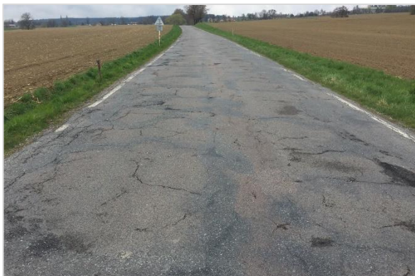
93/ Mozaikové trhliny a vznikající výtluky (II/360: Horní Sloupnice – Němčice)
