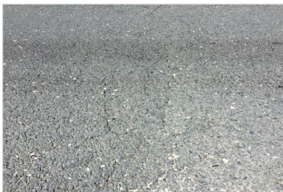
63/ Příčná rozvětvená trhlina v počátečním stadiu (I/35: Moravská Třebová, u okružní křižovatky)
