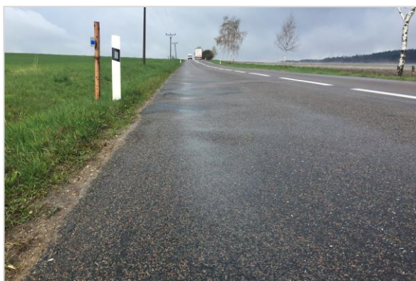
82/ Podélný pokles způsobuje nefunkční odvodnění jízdního pásu (II/315: Sruby – Choceň)
