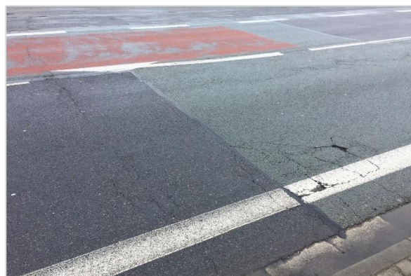
59/ Rozvětvená příčná a mozaiková trhlina v místě styku dvou asfaltových směsí (I/35: Jaroslav 47)
