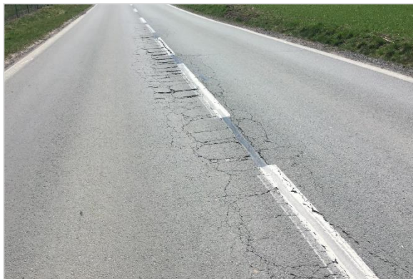
100/ Síťové trhliny a velké výtluky na středě vozovky na zrekonstruovaném úseku (II/371: Městečko Trnávka)
