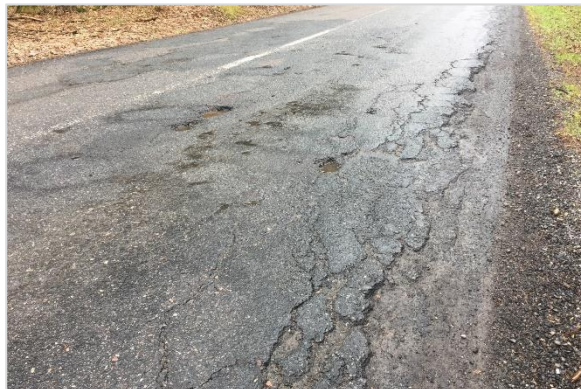
92/ Výtluky, síťové trhliny a olamování okrajů na vnější straně směrového oblouku (II/360: Ústí nad Orlicí – Řetůvka)
