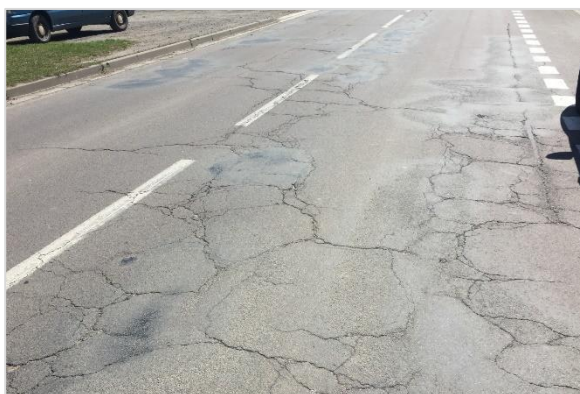
98/ Mozaikové trhliny a z nich vznikající výtluky (II/366: Jevíčko)
