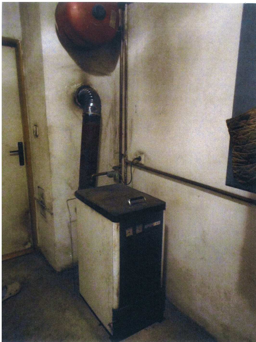
Foto č. 4 - Připojení kouřovodu kotle do komína
