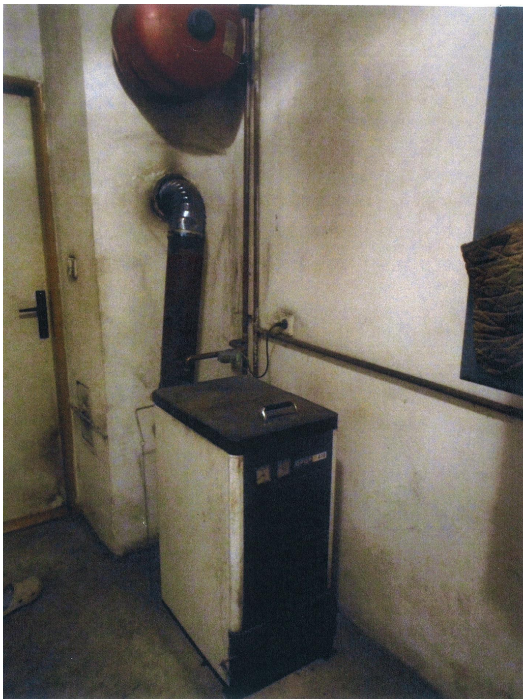
Foto č. 4 - Připojení kouřovodu kotle do komína
