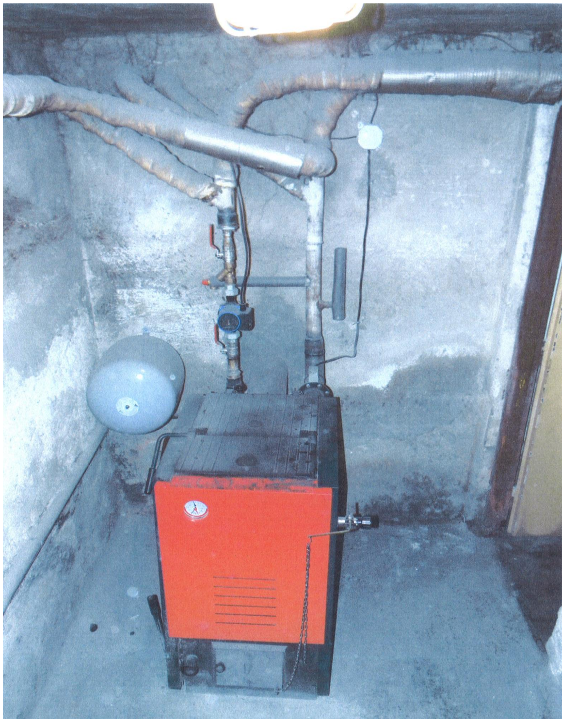
Foto č. 1 – Čelní pohled na kotel
