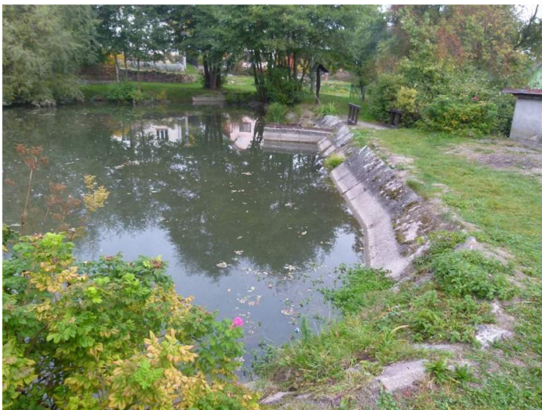
Vegetační porost v tělese hráze
